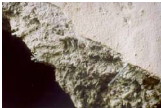
Plaque de fibrociment utilisée pour l'isolation thermique
