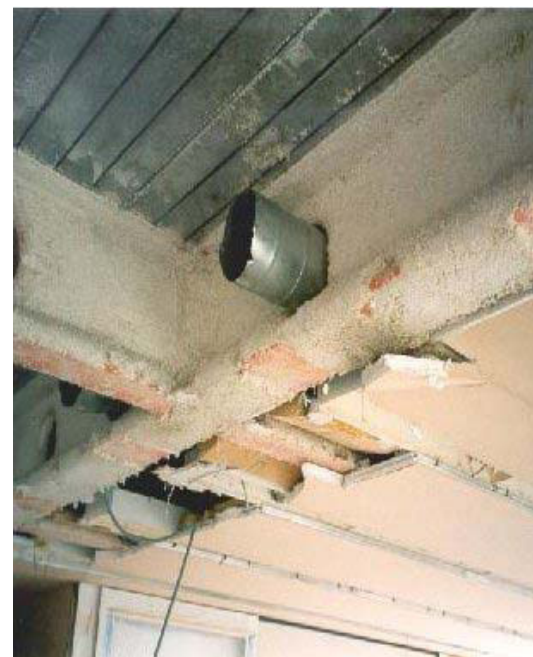
Amiante floqué sur structure métallique
