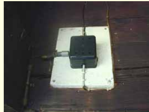
Carton d'amiante derrière un boîtier téléphonique
