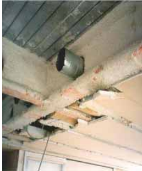
Spritzasbest an einer metallischen Tragkonstruktion
