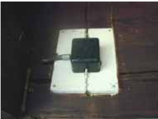
Asbestkarton hinter einem Telefonkasten
