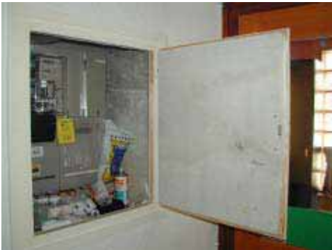
Asbesthaltige Brandschutzplatte im Sicherungskasten
