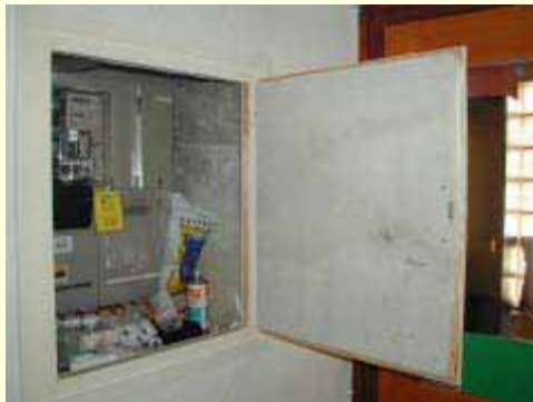
Asbesthaltige Brandschutzplatte im Sicherungskasten
