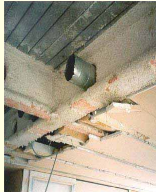
Spritzasbest an einer metallischen Tragkonstruktion
