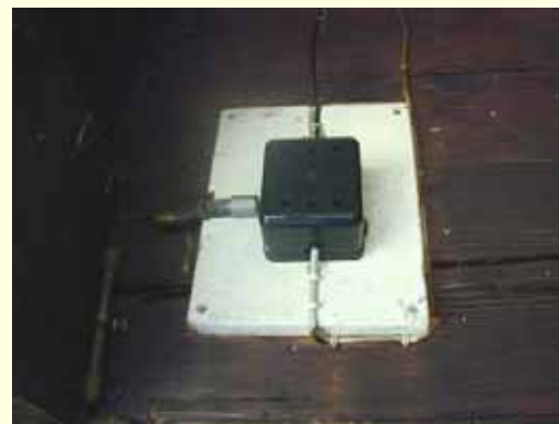
Asbestkarton hinter einem Telefonkasten
