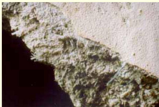
Bruchstelle einer Asbestzementplatte zur Wärmedämmung
